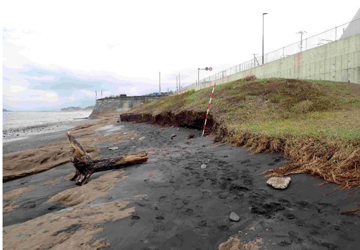
流木が台風時のドリフトライン
